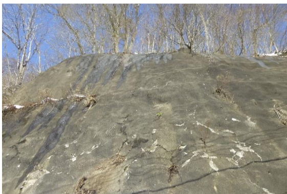
凍結融解による吹付自体の劣化
