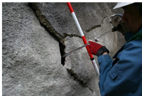
地山の土砂化・風化によるはらみ出し
