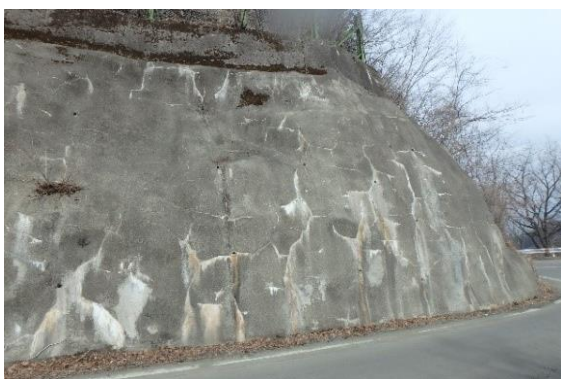
乾燥収縮・凍結融解などによるひび割れ
