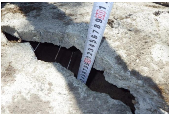
吹付背面の空洞化
