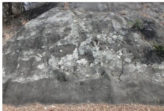
寒冷地での凍結による表層剥離
