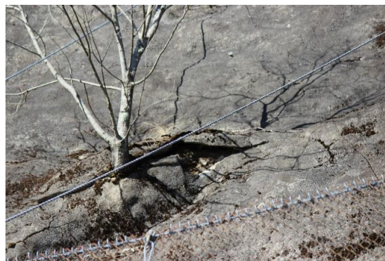
地山の土砂化による根上がり現象
