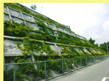
グリーンポケット+法砕工 フジでコンクリート面を被覆し、安全性確保と景観向上を両立します。
