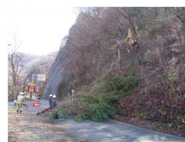
〈棚下②〉道路斜面倒木処理
