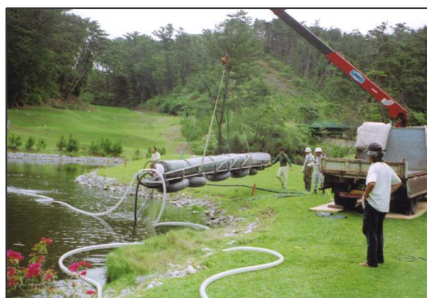
クレーンで「青いみみず」本体を吊り上げ、水面に運び、タイヤチューブで浮かべて設置位置まで移動しました。
